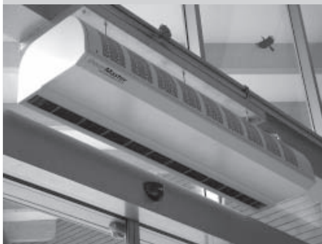
Obrázek 3 – instalace nad vchodové dveře
